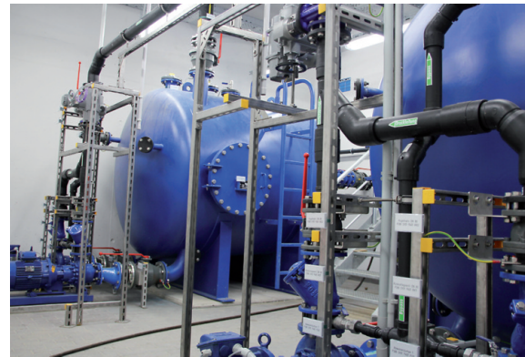
Abbildung 2: Vakuumstation in der Jenfelder Au. Mehr als 700 Haushalte werden hier an den HAMBURG WATER Cycle® angeschlossen, um das Abwasser als vielfältige Ressource zu nutzen. (Quelle: HAMBURG WASSER)
